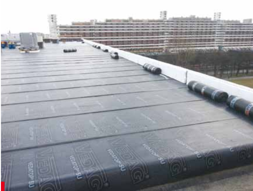
Rys. 5. Papa samoprzylepna Vedatop SU ułożona na styropianie stanowi pierwszą warstwę hydroizolacji, zapewnia szczelność dachu zaraz po jej ułożeniu oraz stanowi skuteczną barierę dla ognia przy zgrzewaniu papy nawierzchniowej
