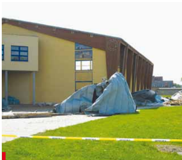
Rys. 10. Zerwane przez wiatr pokrycie z blachy na rąbek
